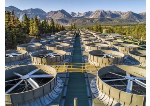
Casa Diablo Geothermal
