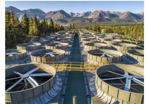
Casa Diablo Geothermal
